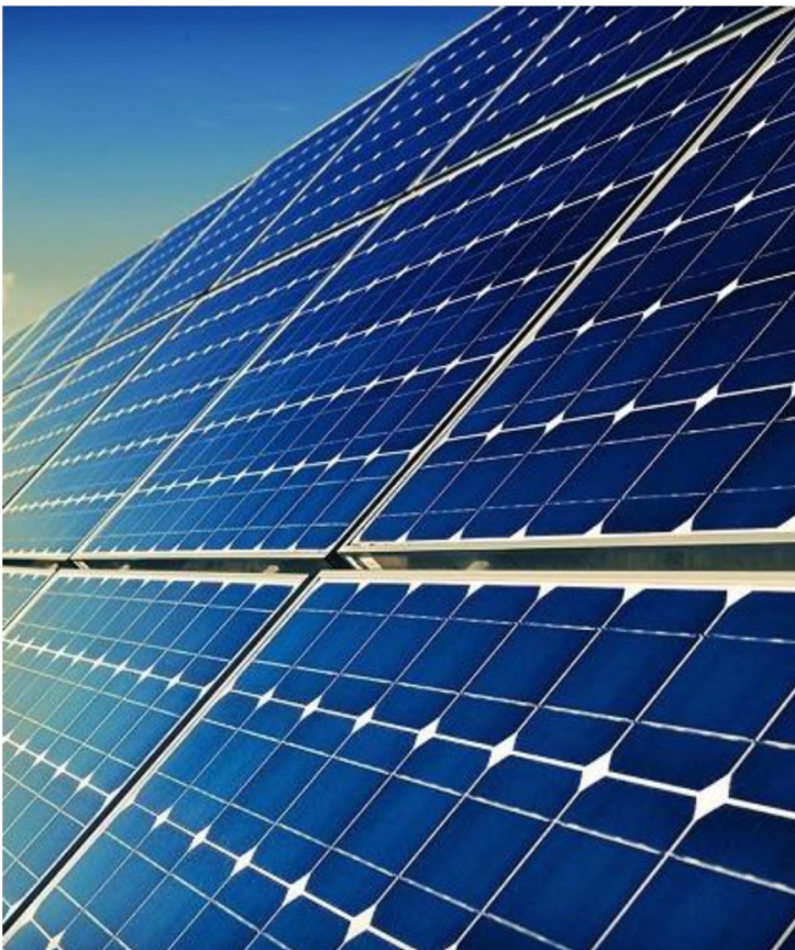
Planta de energía solar para inyectar electricidad en la red
