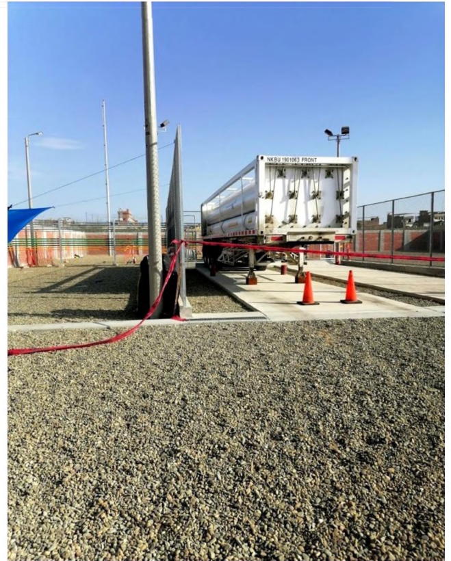
Planta de alimentación de GLP con protección contra pararrayos atmosférico
